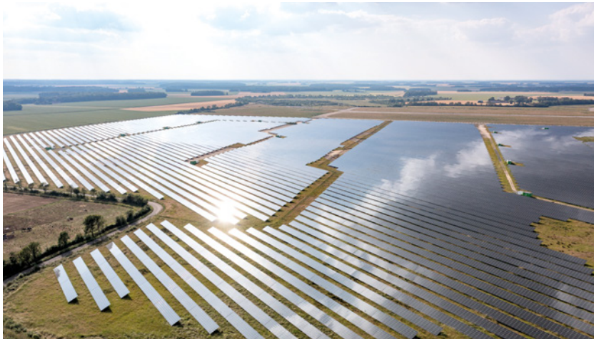
Le parc photovoltaïque à Crucey-Villages
